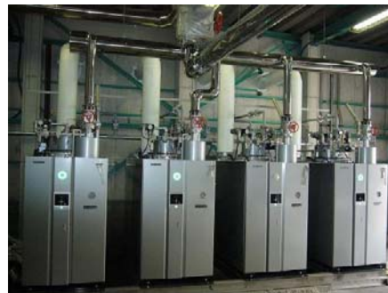
省エネ型ボイラーの導入
