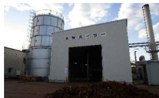
木材乾燥機の熱源となる木くずボイラー
