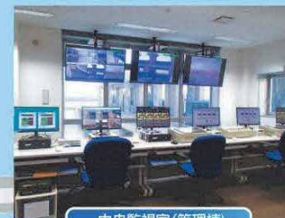
中央監視室(管理棟)
