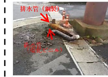
建部歩道橋付属物落下事故 2015年（滋賀県）
