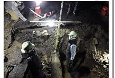
原峠送水管損傷事故 2021年（長野県）
