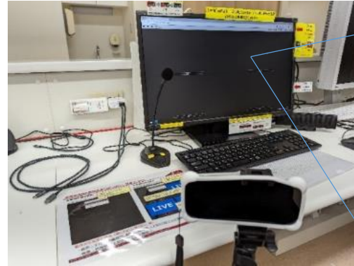
ICU設置環境
