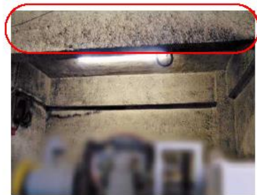
機械室吸音材
