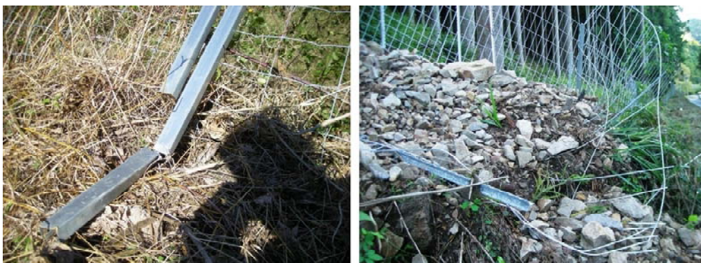
写真1 大規模柵の破損事例
