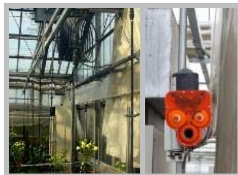
省力化に大きく貢献する設備 左：自走式防除機 右：内張りの自動カーテン
