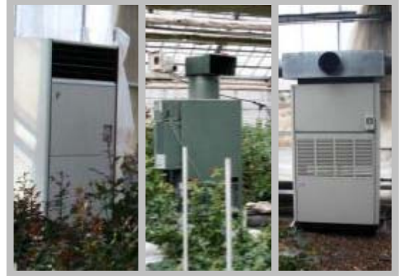
高度な環境制御を実現する機器 左：ヒートポンプ 中：炭酸ガス発生器、右：除湿機
