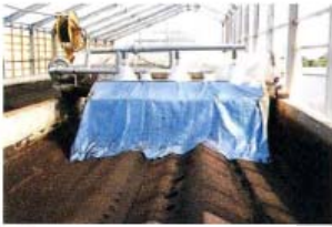
スポット脱臭堆肥化施設
