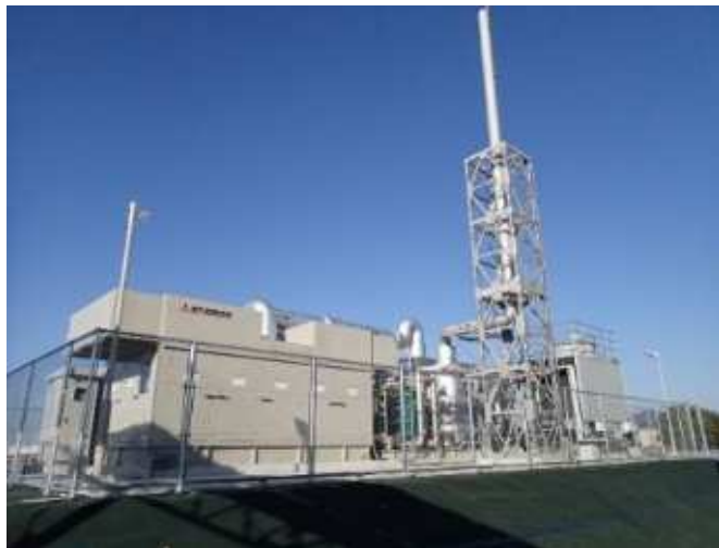
バイオガス発電 (電力会社へ売電: 豊川浄化センター)
