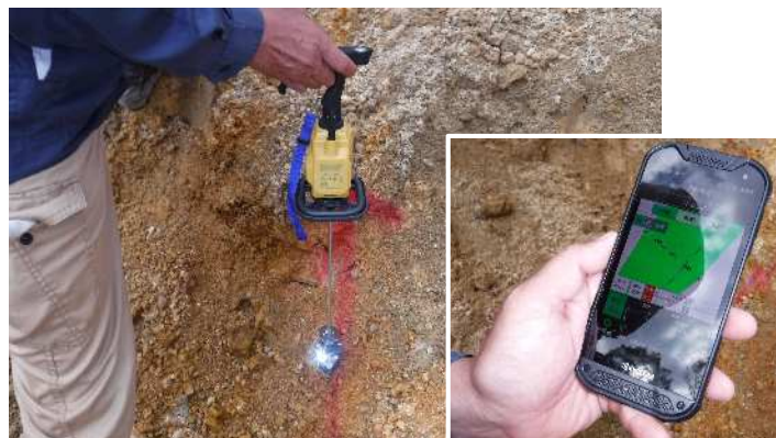
リモートコントロールシステム（T S遠隔操作）を用いた掘削前確認
