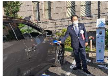
EV、PHV用充電インフラ
