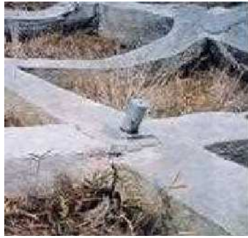
写真 受圧構造物の破損の例
