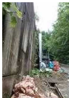
写真 壁面の傾斜の例
