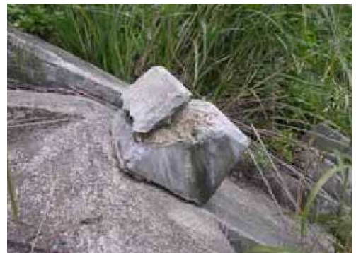
写真 頭部コンクリートの 破損の例
