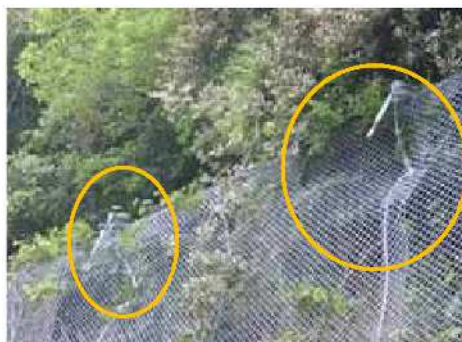
写真 部材の変形・の傾動・鋼部材の破断の例（落石防護網の支柱傾動。金網変形・ワイヤロープ破断）
