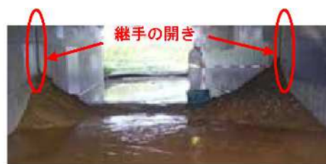
写真 継手の開きおよび 水や土砂の流入の例
