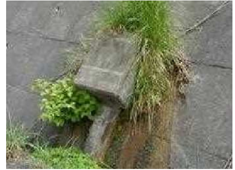
写真 アンカー頭部からの 湧水・雑草の繁茂の例
