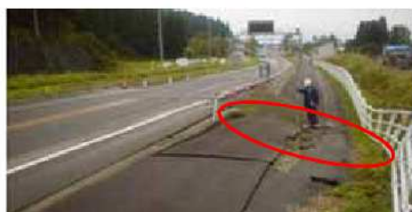
写真 盛土の損傷（沈下）の例
