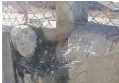
写真 コンクリート部材の剥離・クラックの例（落石防護擁壁）
