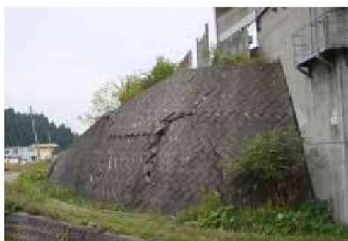
写真 壁面の割れの例
