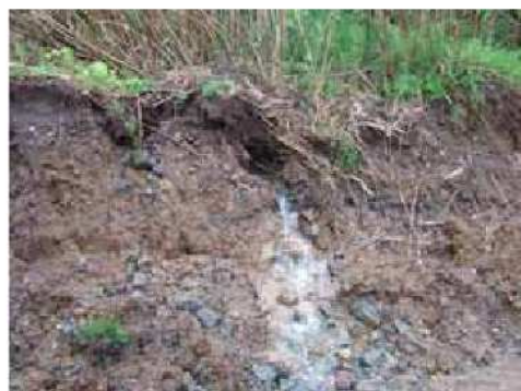
(d) のり尻部の崩壊と湧水の例
