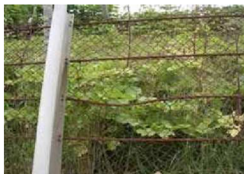
写真 鋼部材の著しい腐食の例（落石防護柵金網・ワイヤーロープ）
