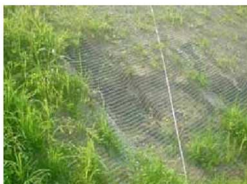
(c) のり尻部が脆弱化し、湧水等により盛土材が流出している例
