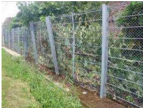
写真 落石防護柵の傾動の例
