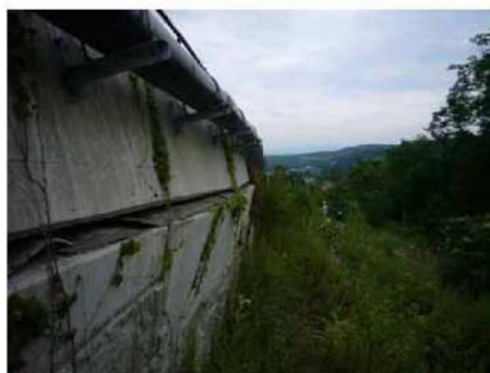
写真 防護柵基礎の傾斜の例
