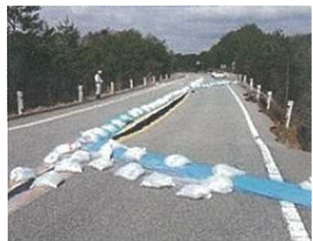
写真 路面の沈下の例
