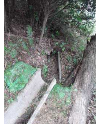
写真 排水溝の破損の例
