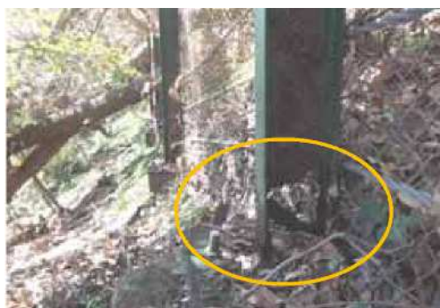
写真 鋼部材の著しい腐食の例（落石防護柵H鋼支柱基部）
