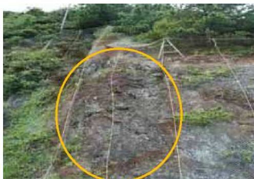
写真 鋼部材の著しい腐食・破断の例（落石防護網の金網）
