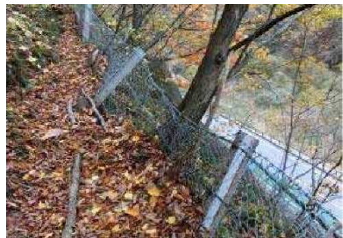
写真 部材の変形・傾動の例 (落石防護柵)
