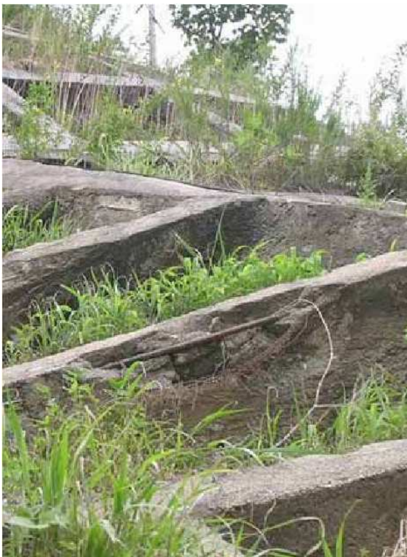
(b) 劣化したのり枠のモルタル片
