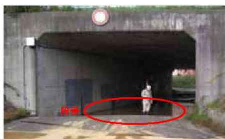
写真 取付け道路面と内部 道路面段差の例
