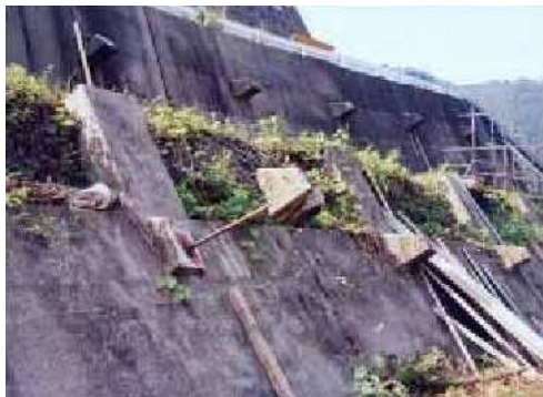
写真 アンカー飛び出しの例
