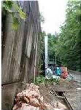
写真 壁面の傾斜の例
