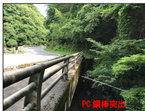
写真 2-2 横締め PC 鋼材突出事例（上犬伏橋）
