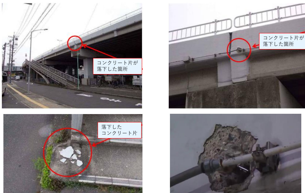
写真 2-1 横締め PC 鋼材突出事例（名古屋市熱田陸橋）
