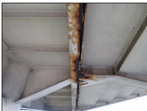
写真 3.5.9-9 接合部の腐食事例
