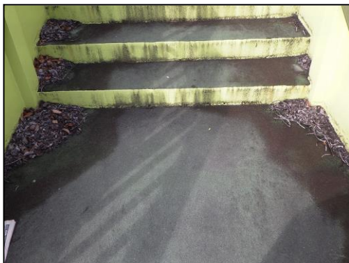
写真 3.5.9-3 踊り場部の土砂堆積事例
