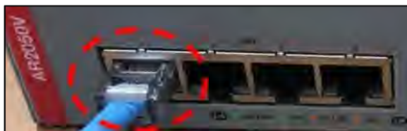
無線ルータ (LAN ポート)
