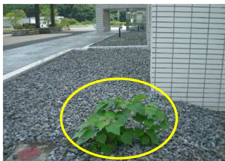
中央研究棟前のバラストの中にも…
