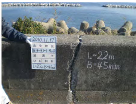
波返し工ひび割れ (三重県鈴鹿市)
