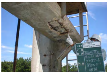
破損 (スライドゲート)
