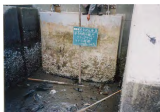
ヘドロの堆積 (フラップゲート)
