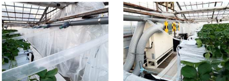
図6. ヒートポンプからの配管の様子
