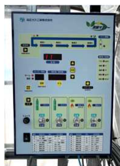
「生ガス式新システム」 制御盤試作機
