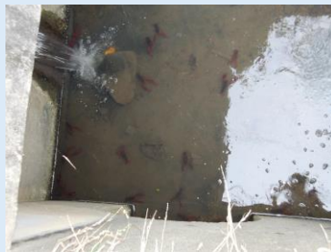
落水後の集水柵の状況
