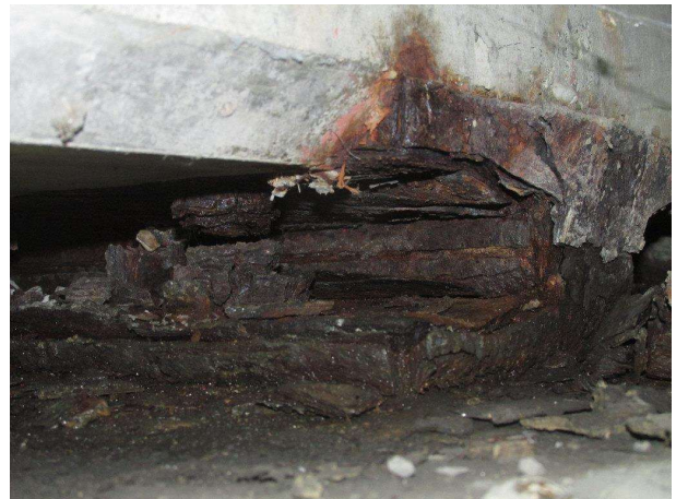
写真 6-29 支承 腐食III
