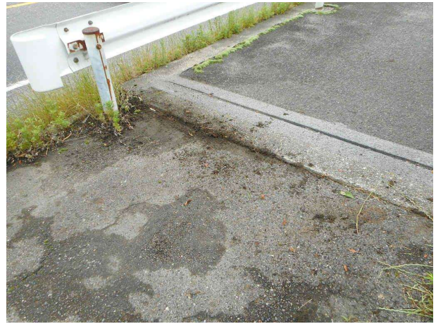
写真 6-16 橋面舗装の凹凸
