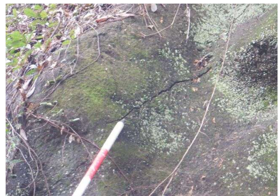
写真 6-46 モルタル吹付工のひびわれ
