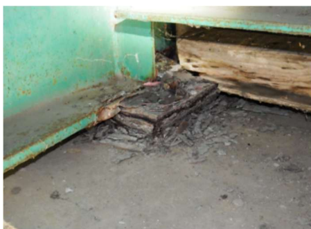
写真 6-1 鋼橋主桁の腐食 (端部の漏水)
