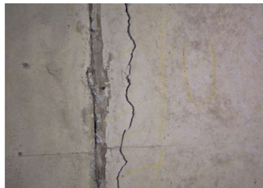
写真 6-36 アーチのひび割れ
