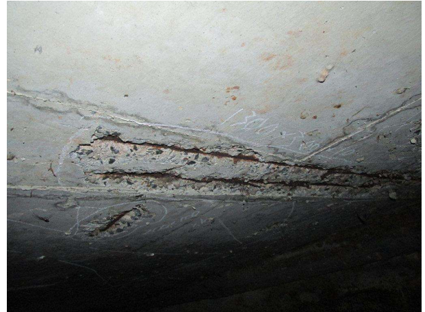
写真 6-25 床版剥離・鉄筋露出III
