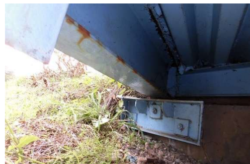
写真 6-2 鋼橋主桁の防食機能の劣化 (湿潤環境下：河川橋)
