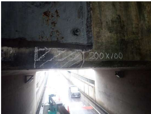
写真 6-41 アンダーパス頂版のうき
