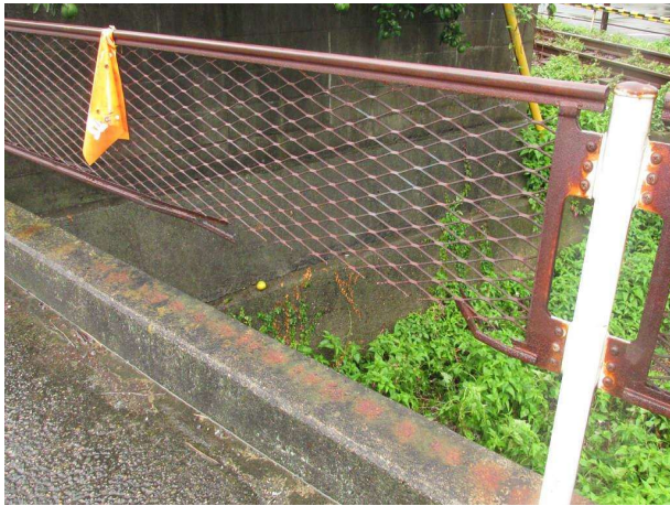
写真 6-13 防護柵の変形
