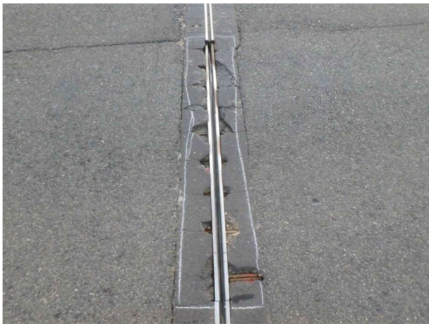
写真 6-17 伸縮装置の変形
