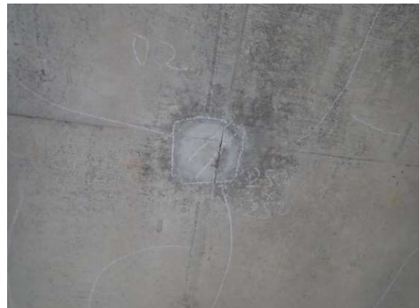
写真 6-42 アンダーパス頂版のうき
