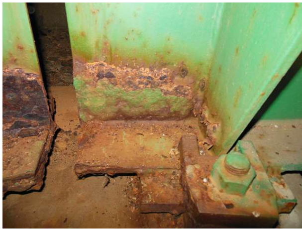
写真 6-18 桁端部の腐食Ⅱ
