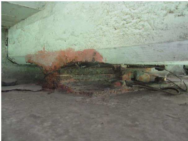
写真 6-28 1巡目点検：支承 腐食II
