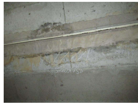
写真 6-6 PC 橋床版のうき（施工不良）
