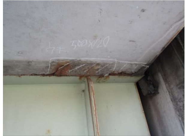
写真 6-21 床版 うき III
