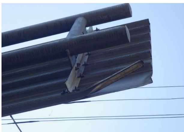
写真 6-50 標識板などの変形・欠損 (破断の恐れあり)
