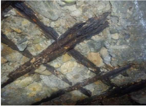
写真 6-3 鋼橋床版の剥離・鉄筋露出 (施工不良：締固め不足)
