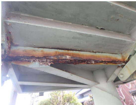
写真 6-43 階段桁の防食機能の劣化
