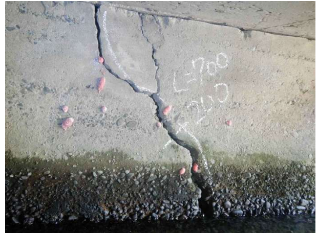
写真 6-27 縦壁 ひびわれIII
