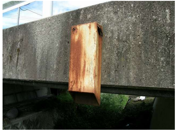
写真 6-14 排水管の腐食
