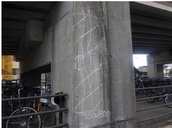
写真 6-9 下部構造のうき (かぶり不足)
