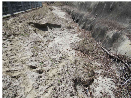
写真 6-38 緩衝材の流出
