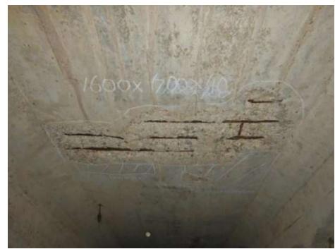
写真 6-8 溝橋床版の剝離・鉄筋露出 (かぶり不足)
