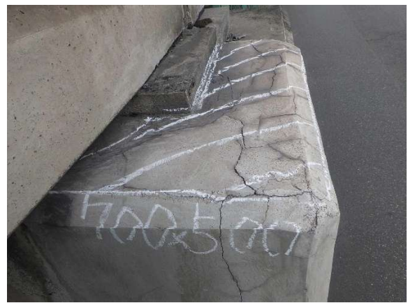
写真 6-10 下部構造のうき (かぶり不足)
