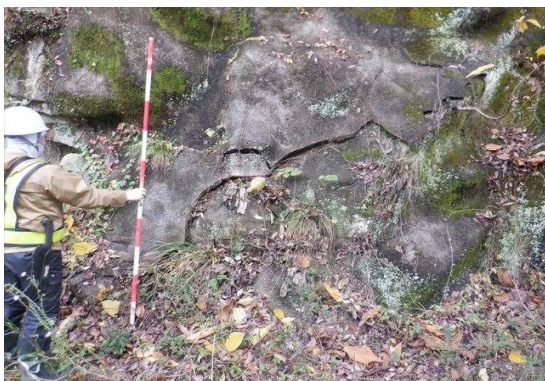
写真 6-45 モルタル吹付工の剥離
