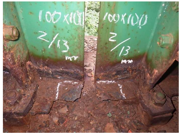
写真 6-19 桁端部の腐食Ⅲ
