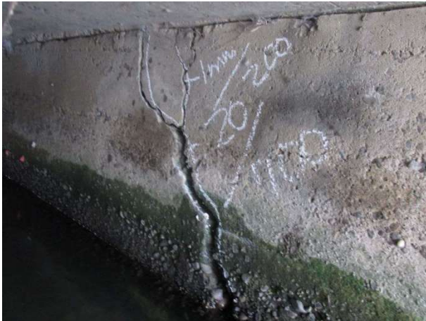
写真 6-26 縦壁 ひびわれII
