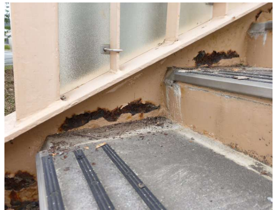
写真 6-44 階段桁の防食機能の劣化
