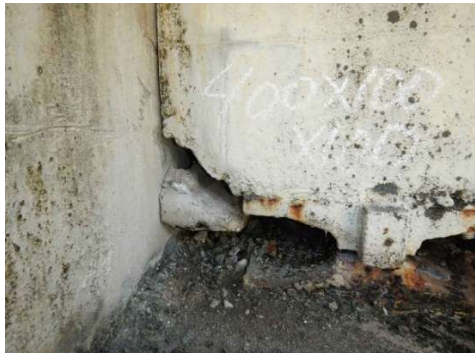
写真 6-7 RC 橋主桁の剝離・鉄筋露出 (中性化)
