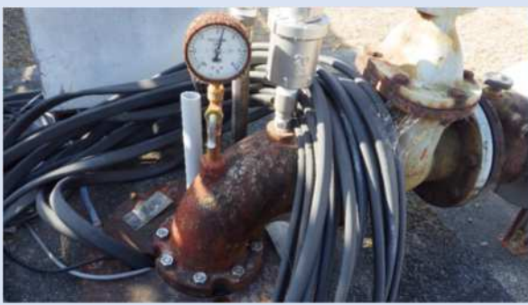
㊨地下水汲み上げ状況 (工水受水事業所 地下水配管、圧力計)
