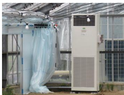
ヒートポンプの導入(豊橋市)
