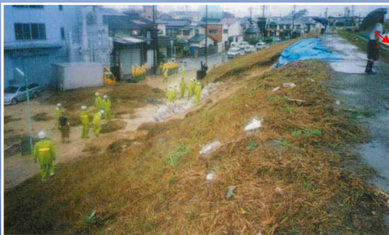
②裏法の崩壊状況(名古屋市南区芝町)
