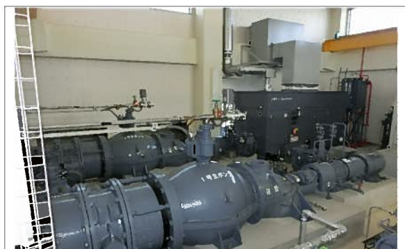
新設された排水機
