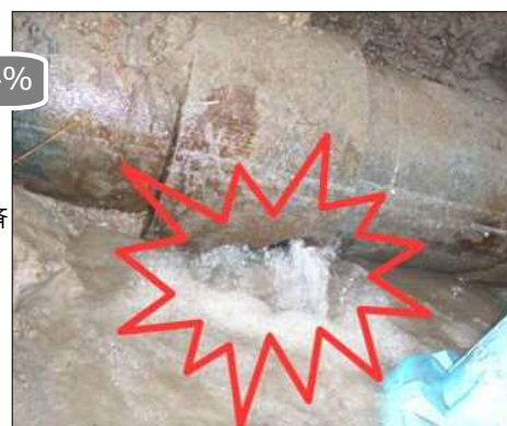
石綿セメント管 破損状況
