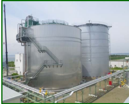
バイオガスの燃料利用 (矢作川浄化センター)
