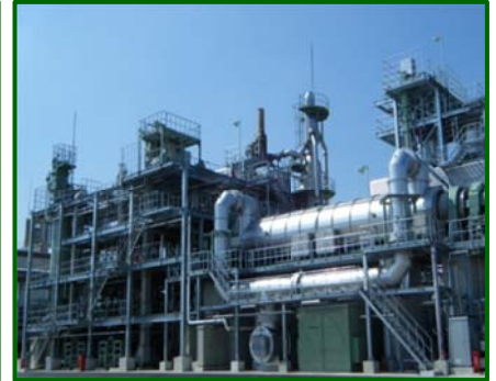
下水汚泥炭化燃料の製造 (衣浦東部浄化センター)
