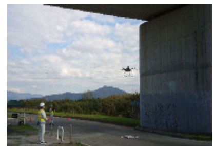
無人飛行ロボットによる 橋梁点検の民間実証実験 ((主)東三河環状線(豊川市):三上橋)
