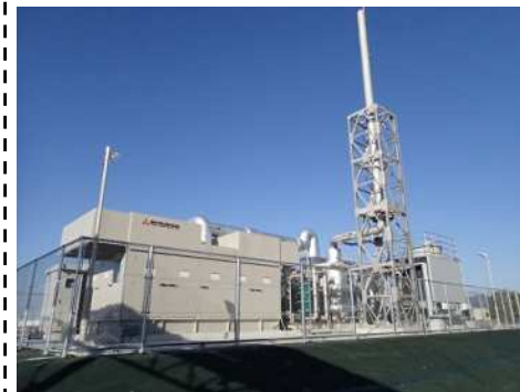
豊川浄化センター (豊橋市) 発電施設
