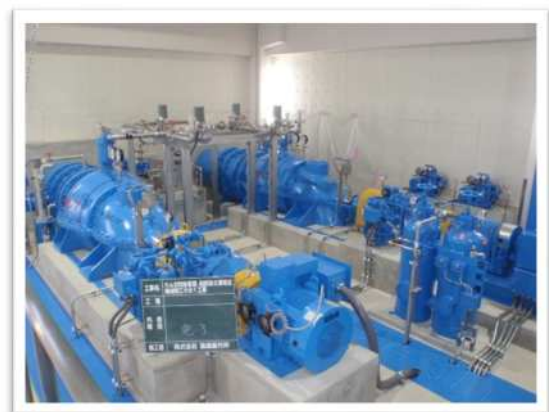
基幹的排水機場の更新(内部)
