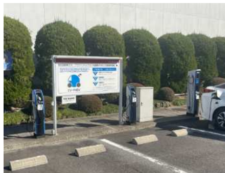
日東工業(株)本社・名古屋工場の設置風景
