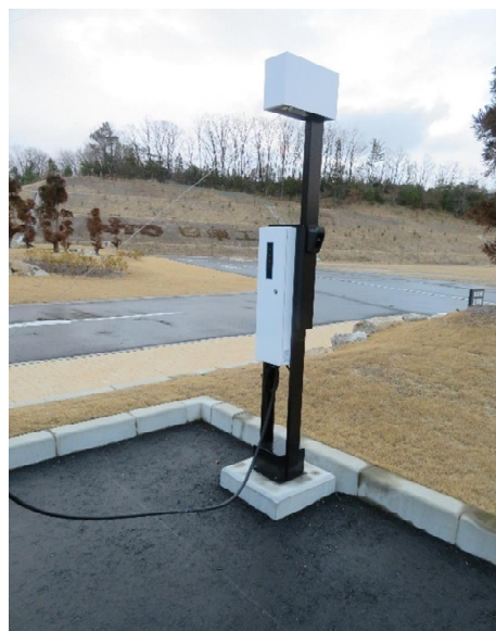
来客駐車場に設置している EV 充電設備
