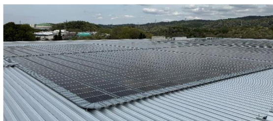
工場の屋根に設置している太陽光発電システム（パネル容量 1,313kW）
