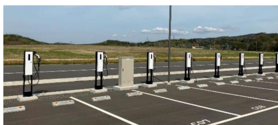
社員駐車場に設置している EV 充電設備
