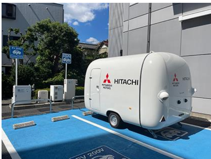
バッテリーキューブから給電している様子
