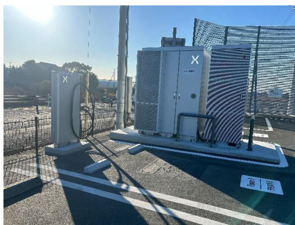
2025 年 1 月に設置した道の駅とよはしの超急速充電器
