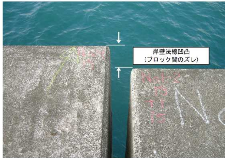
参考写真① 岸壁法線の凹凸（ブロック間のズレ）
