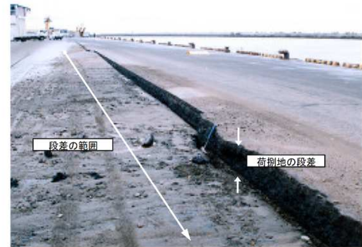
参考写真② 荷捌き地の段差
