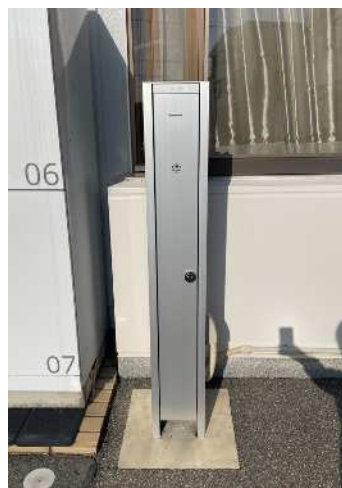
従業員向け充電設備
