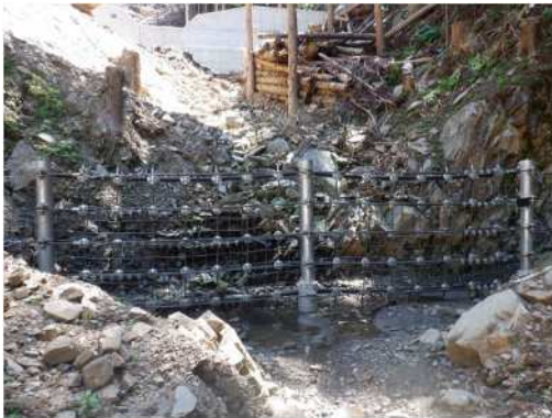
写真1 土石抑止工（アーバンガード）
