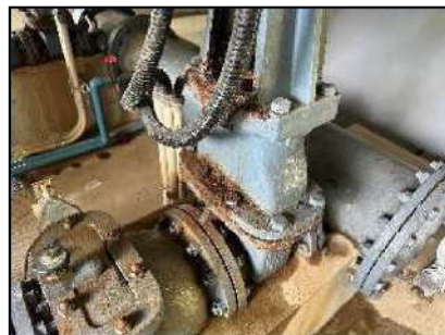
愛知用水<布土揚水機場> (設置から 30 年以上経過)
