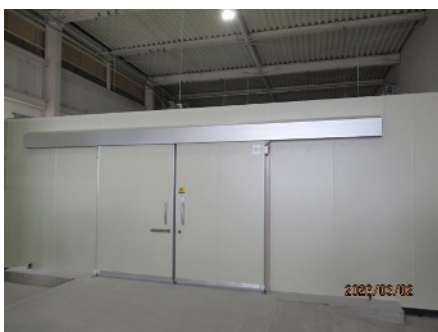
【整備された冷蔵庫】
