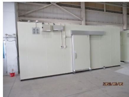
【整備された冷凍庫】
