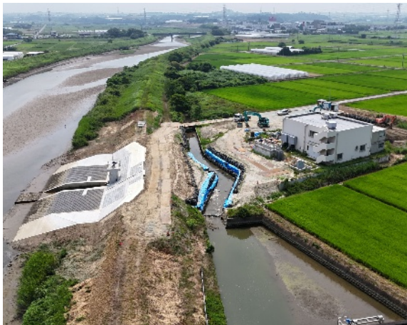
【整備中の野依排水機場】
