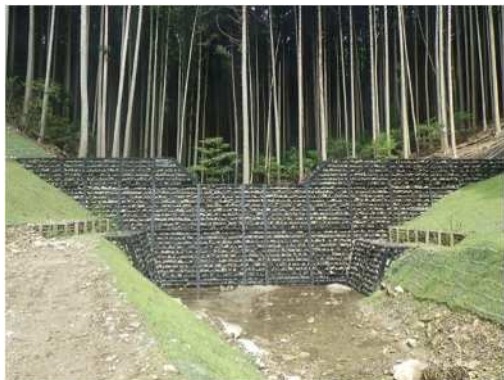
写真 3 谷止工（鋼製自在枠）
