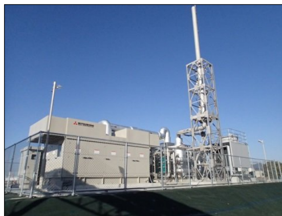
④豊川浄化センター(豊橋市) 発電施設
