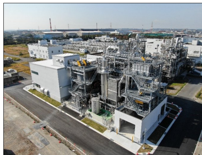
衣浦西部浄化センター(半田市) 共同汚泥処理施設 2022年4月運転開始
