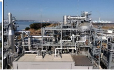
矢作川浄化センター焼却炉(西尾市)
