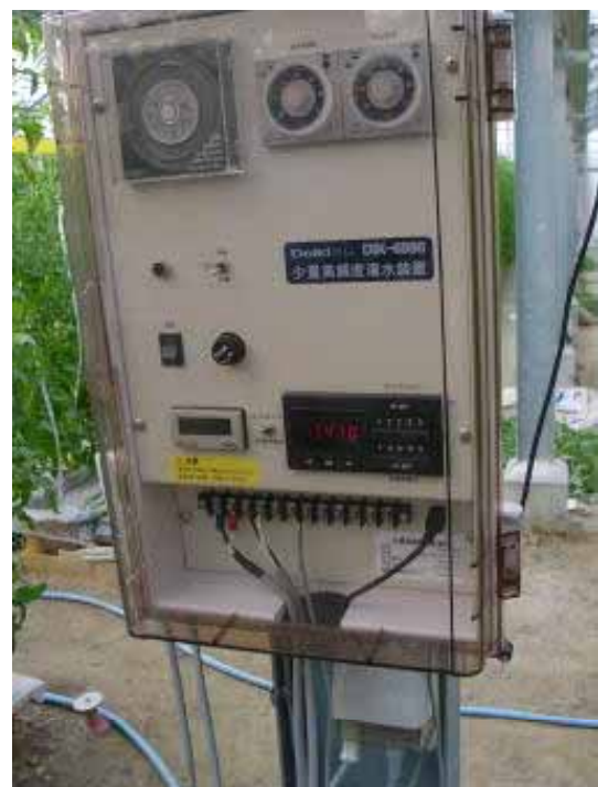
灌水制御装置
