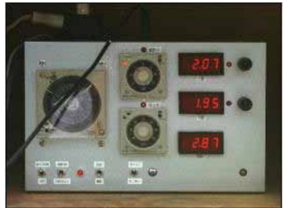
かん水制御装置
